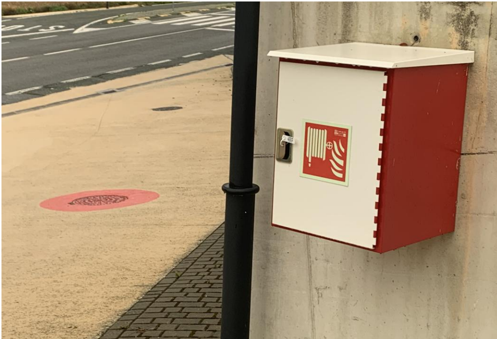
Señalización de hidrantes y cuadro mangueras
