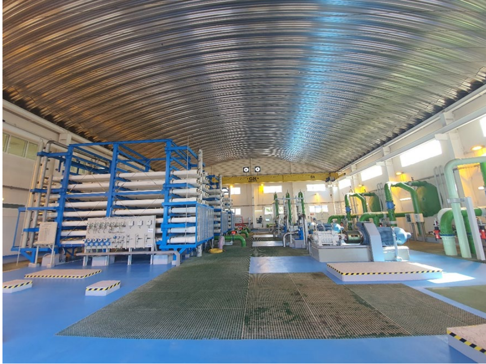
Interior de la EDAM de Abona
