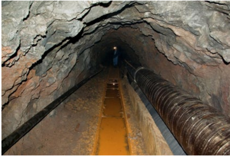
Interior de una galería horizontal donde se observa la conducción de ventilación en el hastial izquierdo y la de aire comprimido
