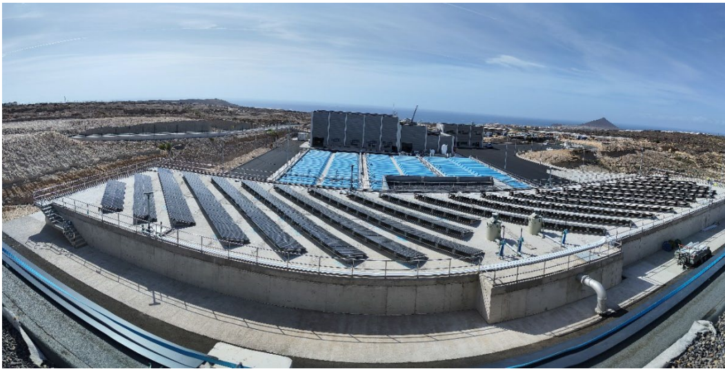
Fotografía EDAR Granadilla con instalación de placas fotovoltaicas
