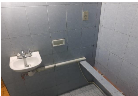
Figura 6: Adaptación de PVC a mingitorios.
