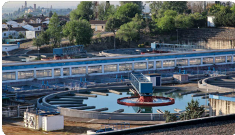
Figura 2. Estación de tratamiento de agua potable El Carambolo, EMASESA
