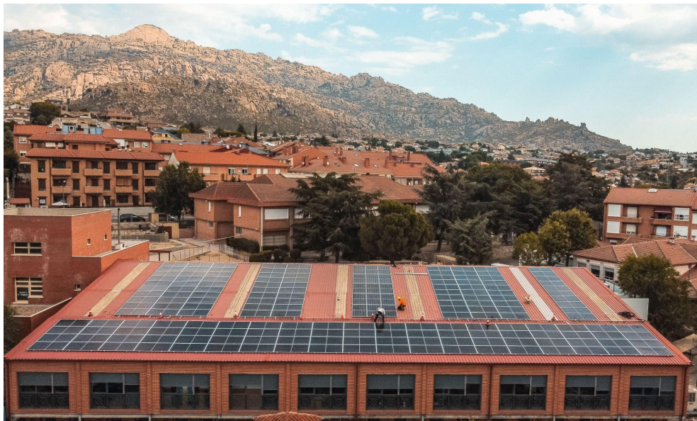
Figura 12. Instalación fotovoltaica ManzaEnergía.
