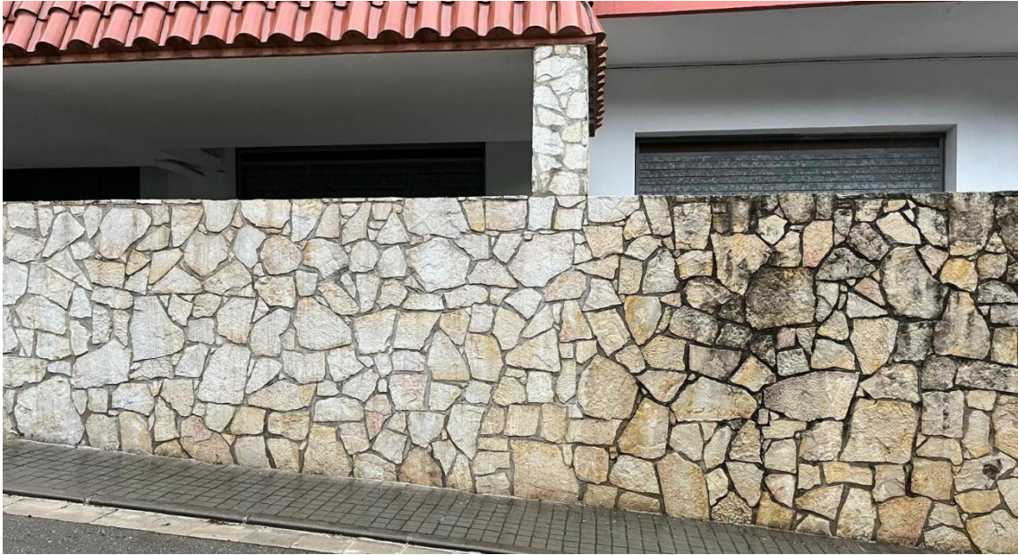
Figura 3. Muro de piedra a la izquierda superficie con aplicación de nanotecnología autolimpiante, a la izquierda sin aplicación [6]
