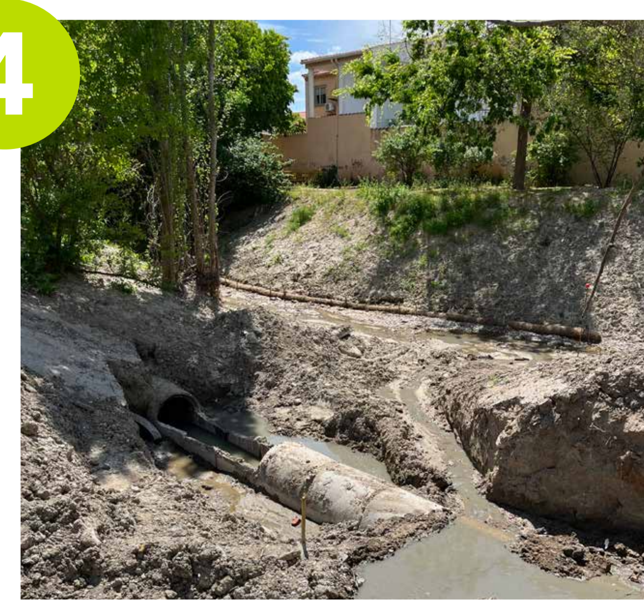
Zona confluencia de arroyo del Cubo y Viñuelas. Rotura de tubería de saneamiento y trabajos de reparación. ABR.2024 (Foto: Caroline Heredia A.)
