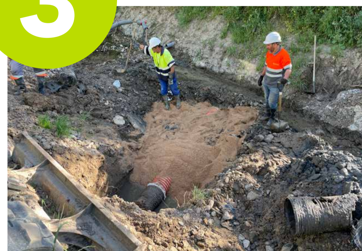
Arroyo el Cubo Estado post-operacional. AGO.2024 (Fotos: Luis Montenegro Lafont)
