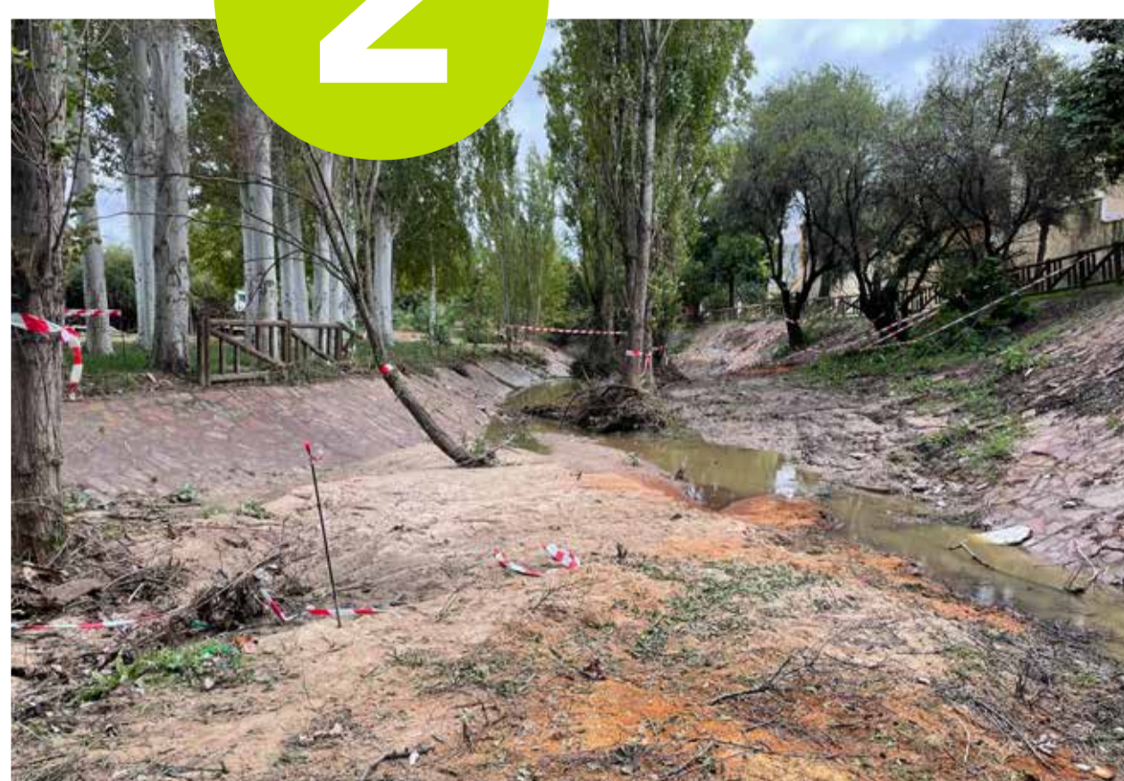
Arroyo Viñuelas Estado previo a demolición y retirada de enchachado. OCT.2023 (Fotos: Luis Montenegro Lafont)
