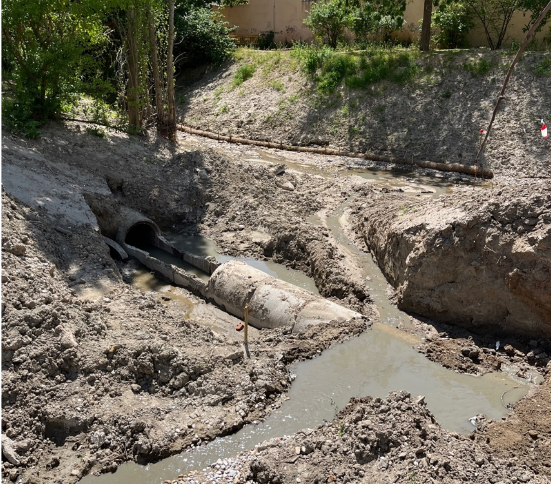
Rotura tubería hormigón (Foto: Caroline Heredia)
