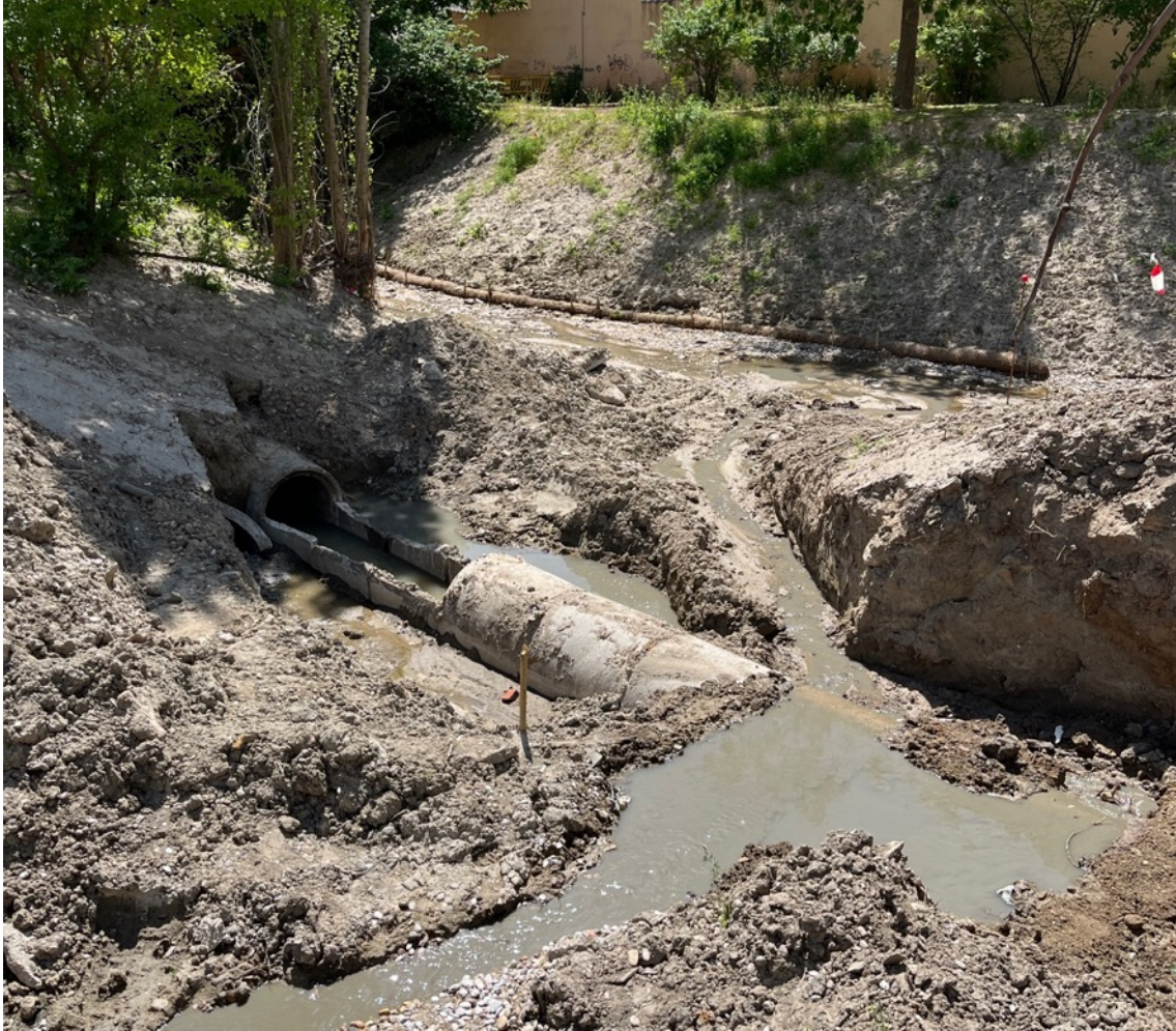
Rotura y trabajos de reparación tubería hormigón (Foto: Caroline Heredia)
