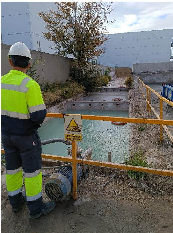
Figura 3. Balsas de decantación y acondicionamiento de aguas recicladas en la Planta de Hormigón de Holcim, en Villaverde (Madrid).
