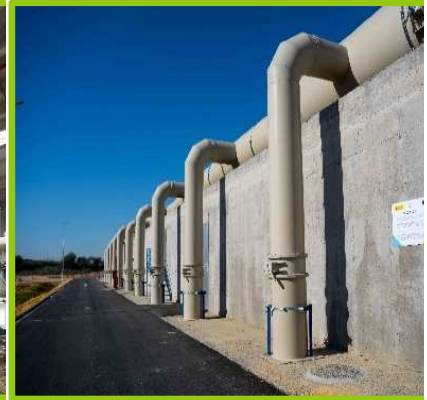
Biofiltros de la PCA
