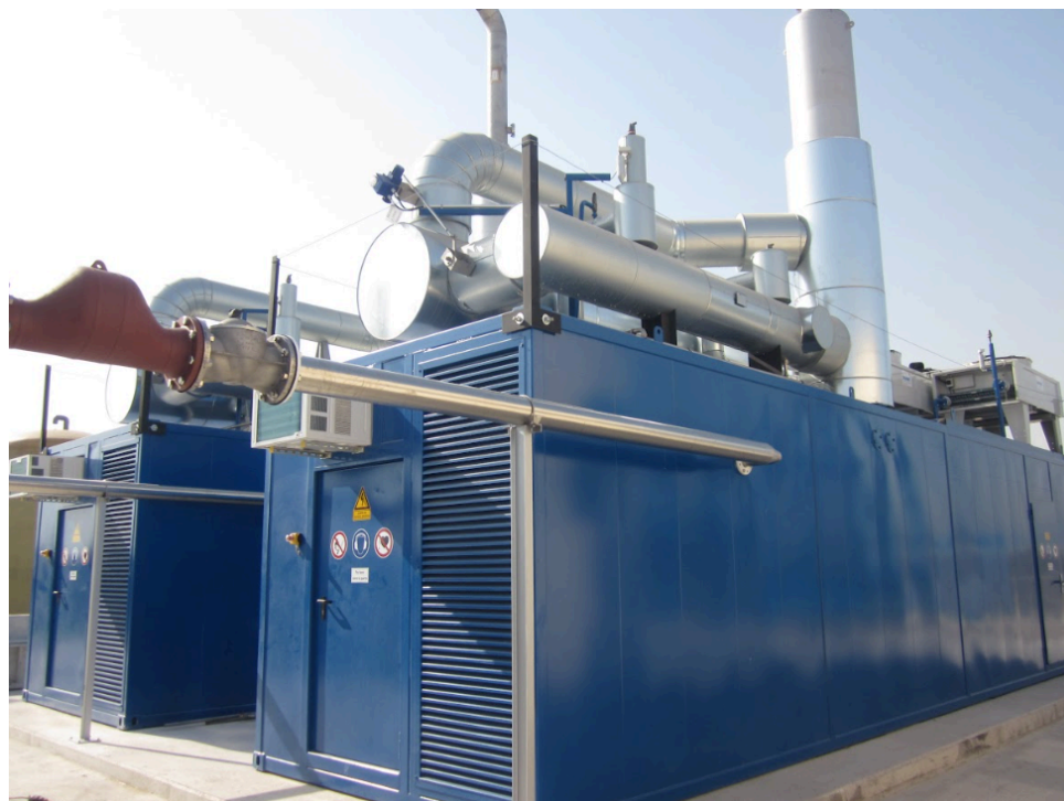
Figura 7. Vista de la planta de cogeneración en la EDAR Murcia-Este
