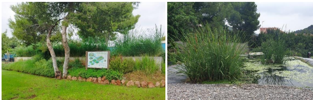
Figura 3. Imágenes de los humedales demostrativos construidos en la EDAR de Los Monasterios. Humedal de flujo subsuperficial vertical con fango de ETAP (izq.) y humedal de flujo superficial (dcha.)
