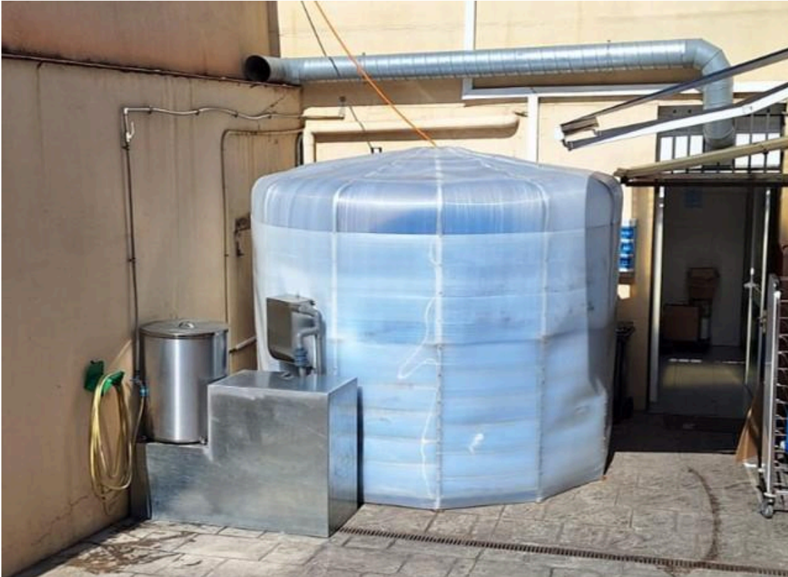
Figura 4. Fotografía de la planta de biogás instalada en el Hospital Viamed.
