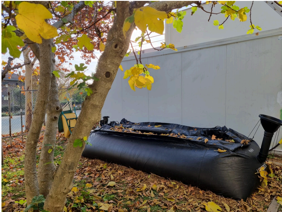
Figura 6. Fotografía del biodigestor instalado en el instituto.
