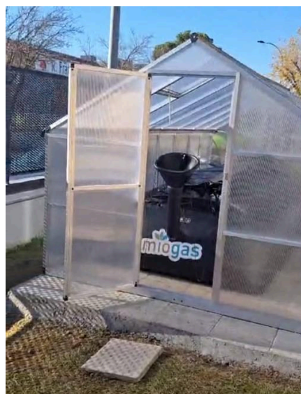
Figura 5. Fotografía del biodigestor instalado en el restaurante.
