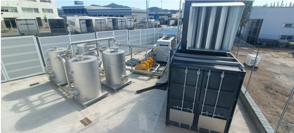
Figura 3: Pretratamiento del biogás y módulo de membranas de producción de biometano.
