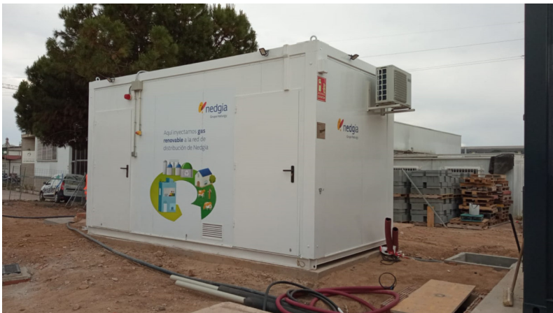
Figura 4: Módulo de inyección a red suministrado por NEDGIA en la fase de obra
